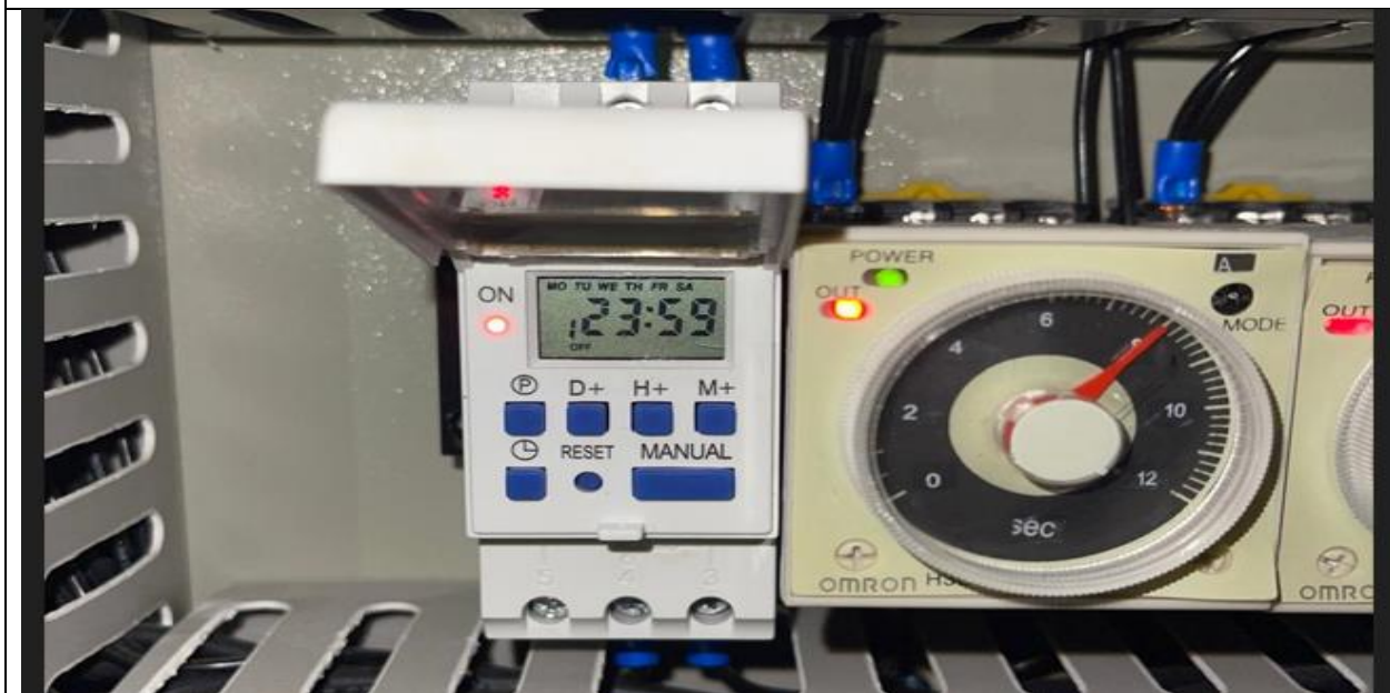
-tampilan program yang sudah tersetting sementara hari-jam-menit ( jadwal yang sudah ter setting di panel Listrik akan mati setiap hari senin s/d sabtu di jam 23:56 malam) total waktu oprasi Videotron 18 jam nonstop di setiap hari nya
