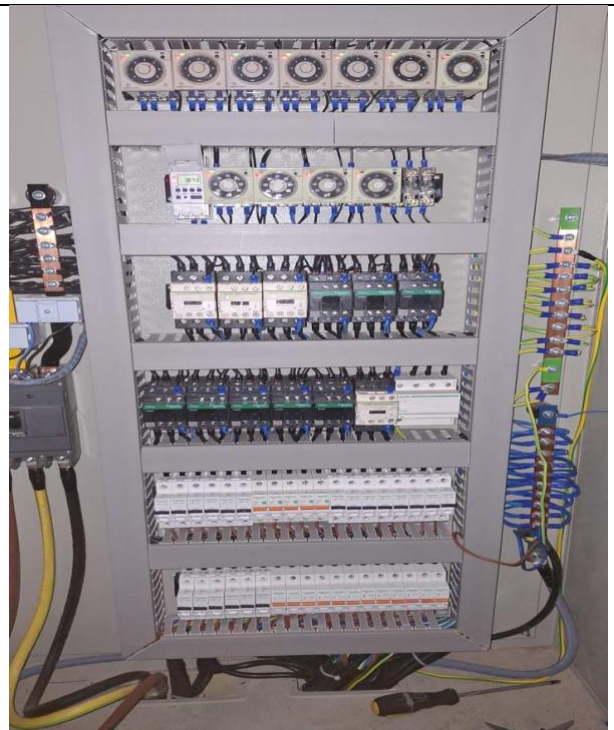
-Tampak dalam area panel Listrik Videotron total 37 mcb Listrik dan 1 sakelar timer digital yang di gunakan sebagai control power Videotron dan Exhoustfan (37 mcb 25 A)
